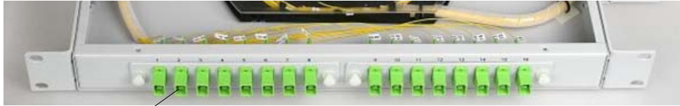
Панель коммутации оптического кросса
